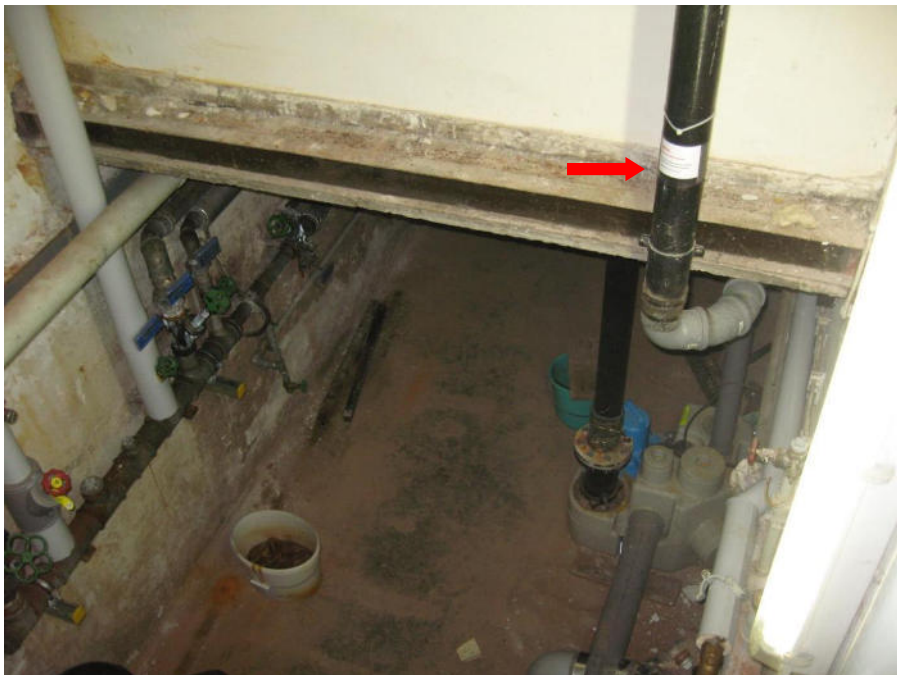
Abb. 2: Keller, vorderer Bereich, hinter der Kellertreppe, neben der Abwasserpumpe
