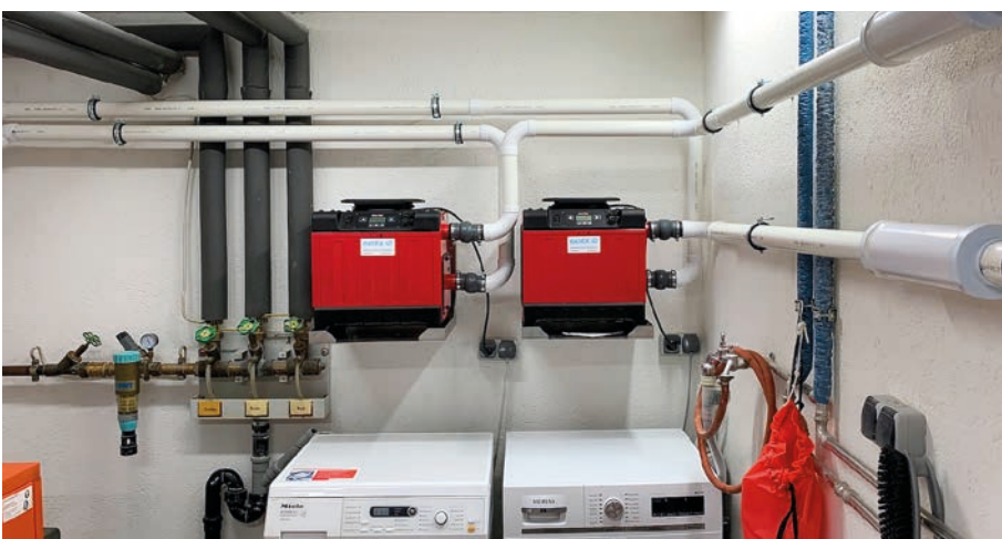
(1) Mit dem Radea-Verfahren wird die mit Radon belastete Bodenluft abgesaugt und aus dem Gebäude geleitet. In schweren Fällen wurde die Radonkonzentration im Gebäude dadurch um mehrere Tausend Becquerel reduziert.
